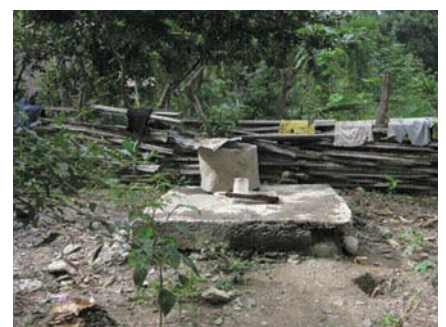
壊れてしまったトイレ
