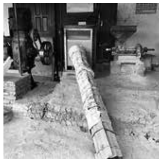
写真2 K 郡 P 村の小型水力 発電機
