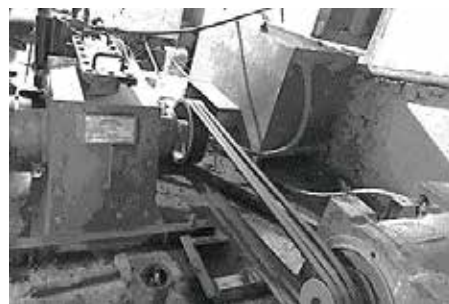
写真3 K 郡 P 村の小型水力発電機の中
