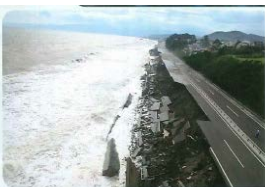
台風による波でこわされた道路 【神奈川県 中郡 2007年】
